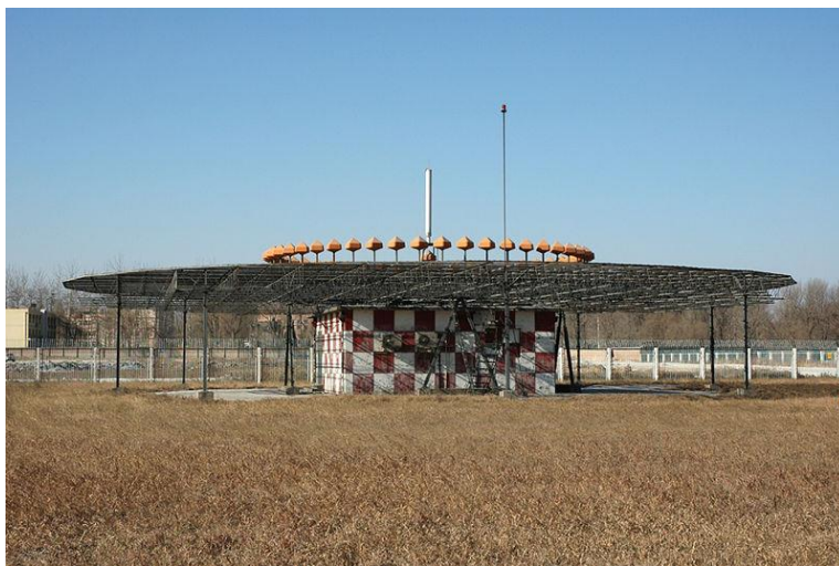
1. ábra: VOR antennaállomás
